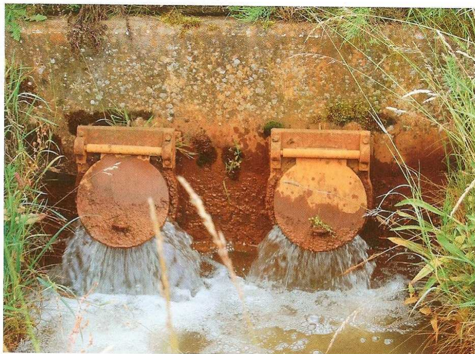
Lozingspunt drainagewater van de verdiept aangelegde en gedraineerde A2 ter hoogte van Best.
