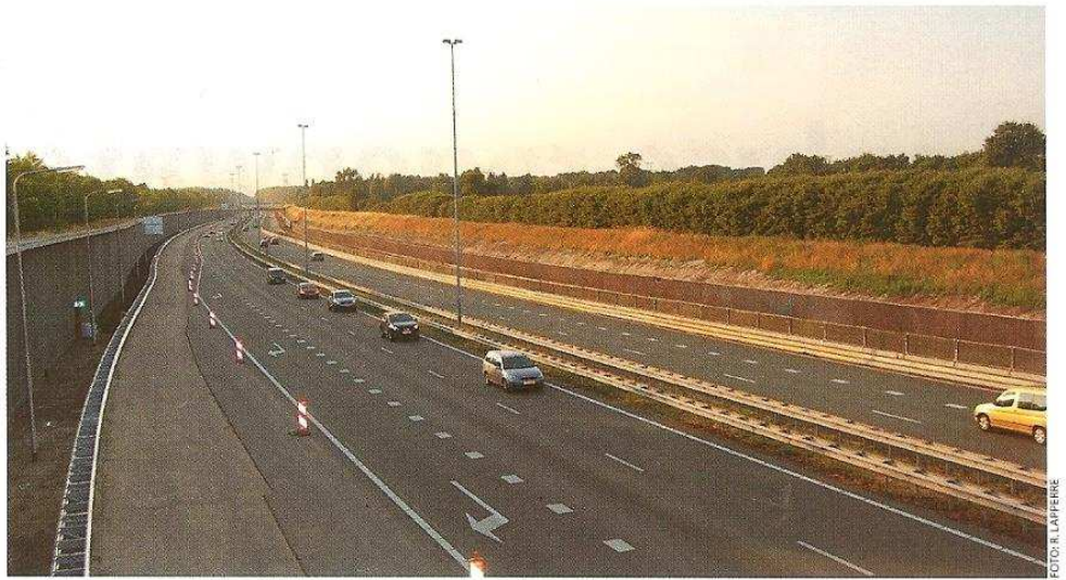
De A2 blijft droog en berijdbaar door een combinatie van damwanden met intensieve drainage.
